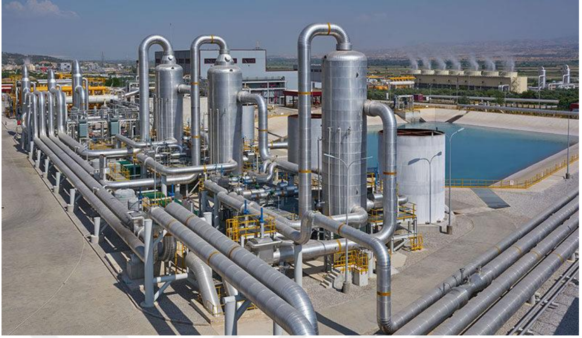
Şekil 3.10 Jeotermal enerji santrali (Anonim, 2019)
