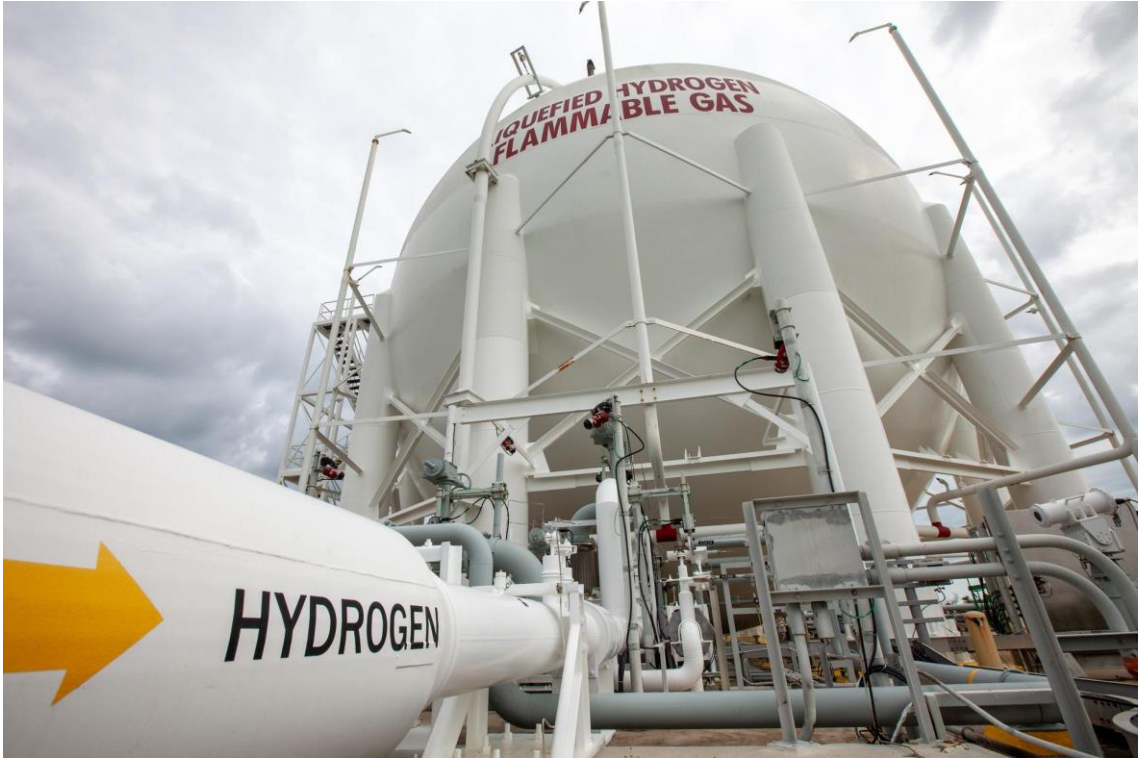
Şekil 3.11 Florida’daki NASA Kennedy Uzay Merkezi’ndeki bir sıvı hidrojen tankı (Anonim, 2021)
